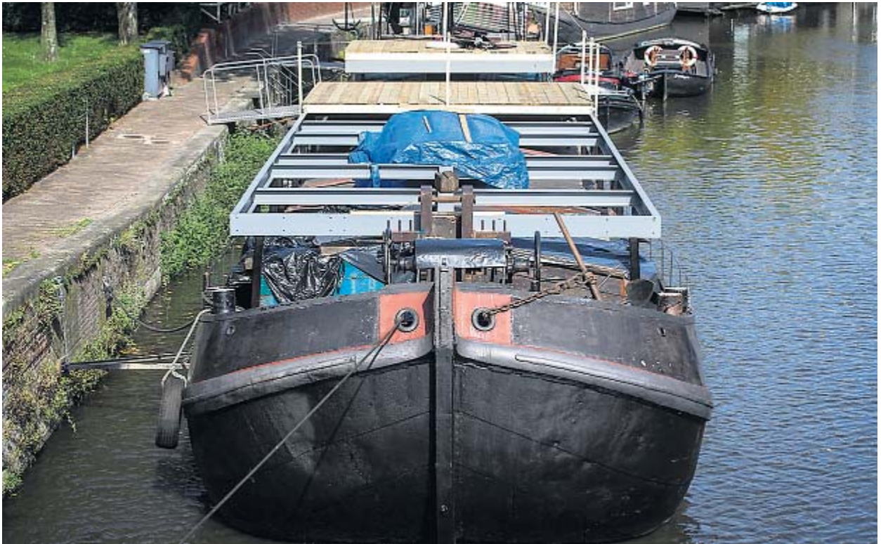
▲ De stalen constructie voor het terras is gemonteerd op het dek van de woonboot. Foto Siese Veenstra
